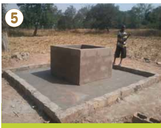
Se alza 1 metro del suelo como medida de seguridad
